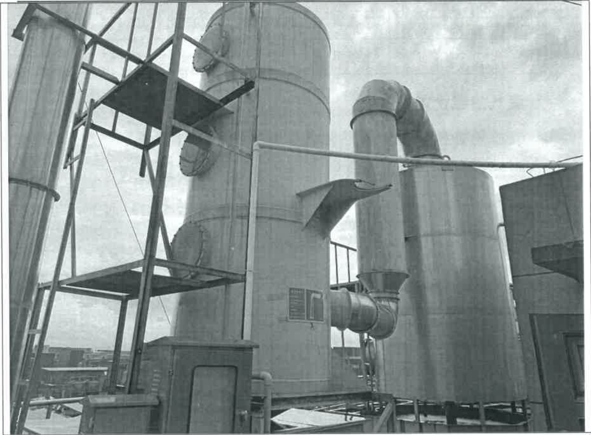
二级水喷淋（热洁燃烧废气）
