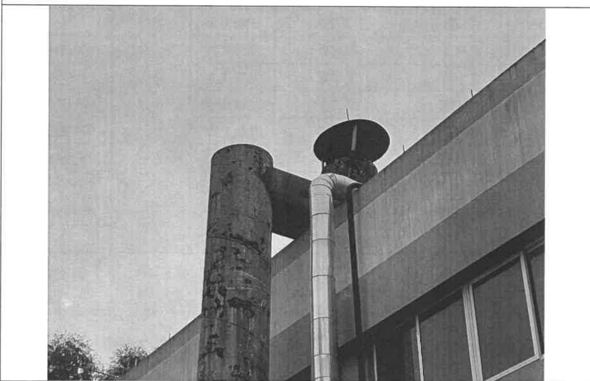
天然气燃烧废气排放口
