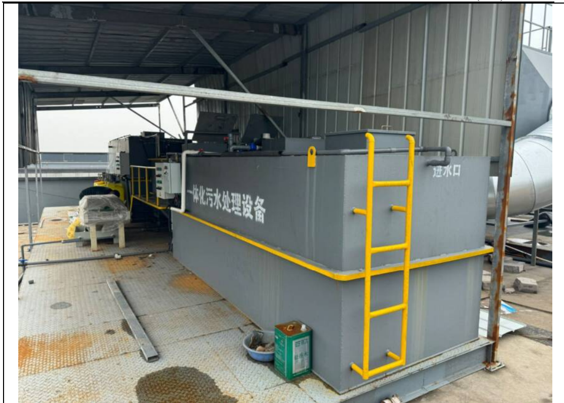
废水处理设施
