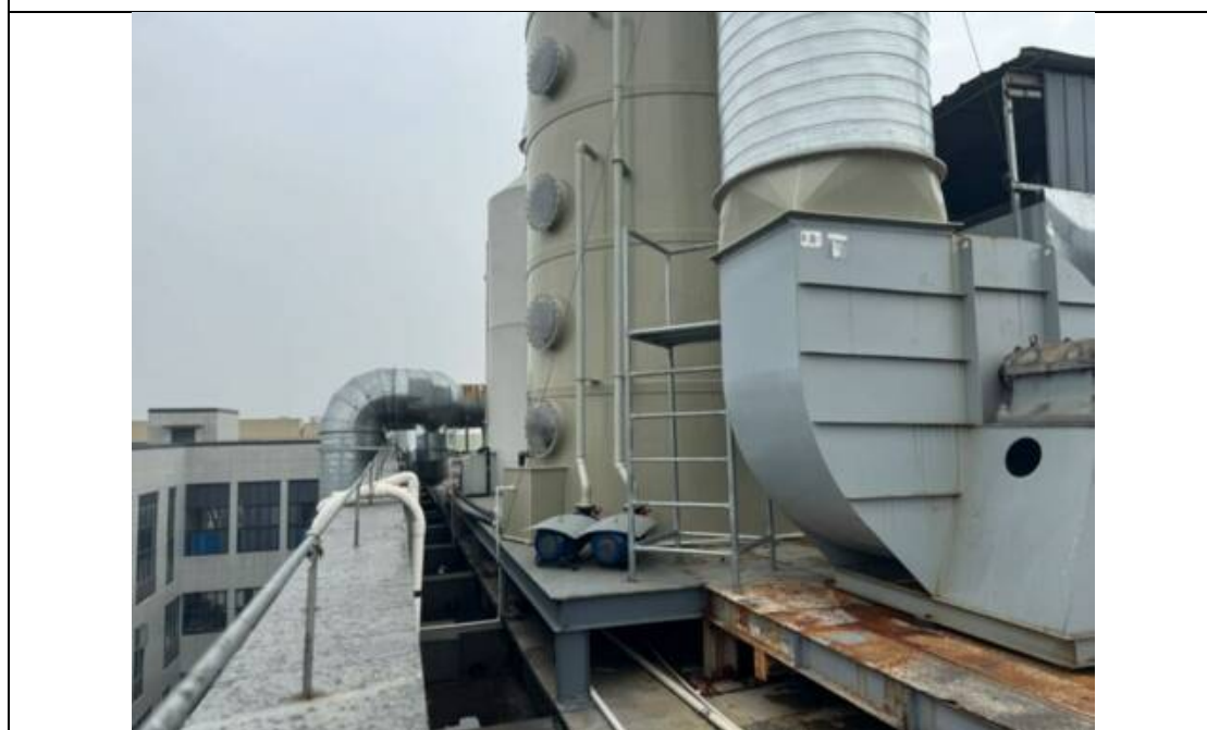
水性印刷废气处理设施
