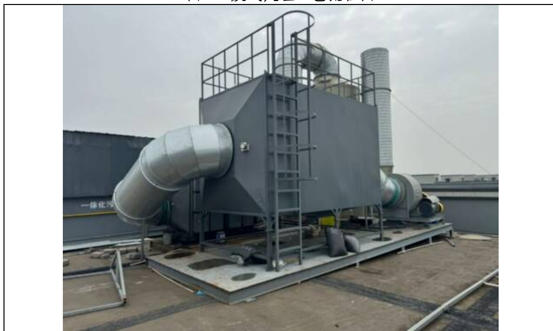
贴合废气处理设施
