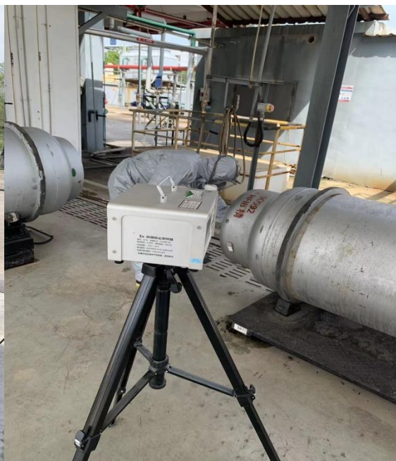
生产车间钢瓶巡检岗位
