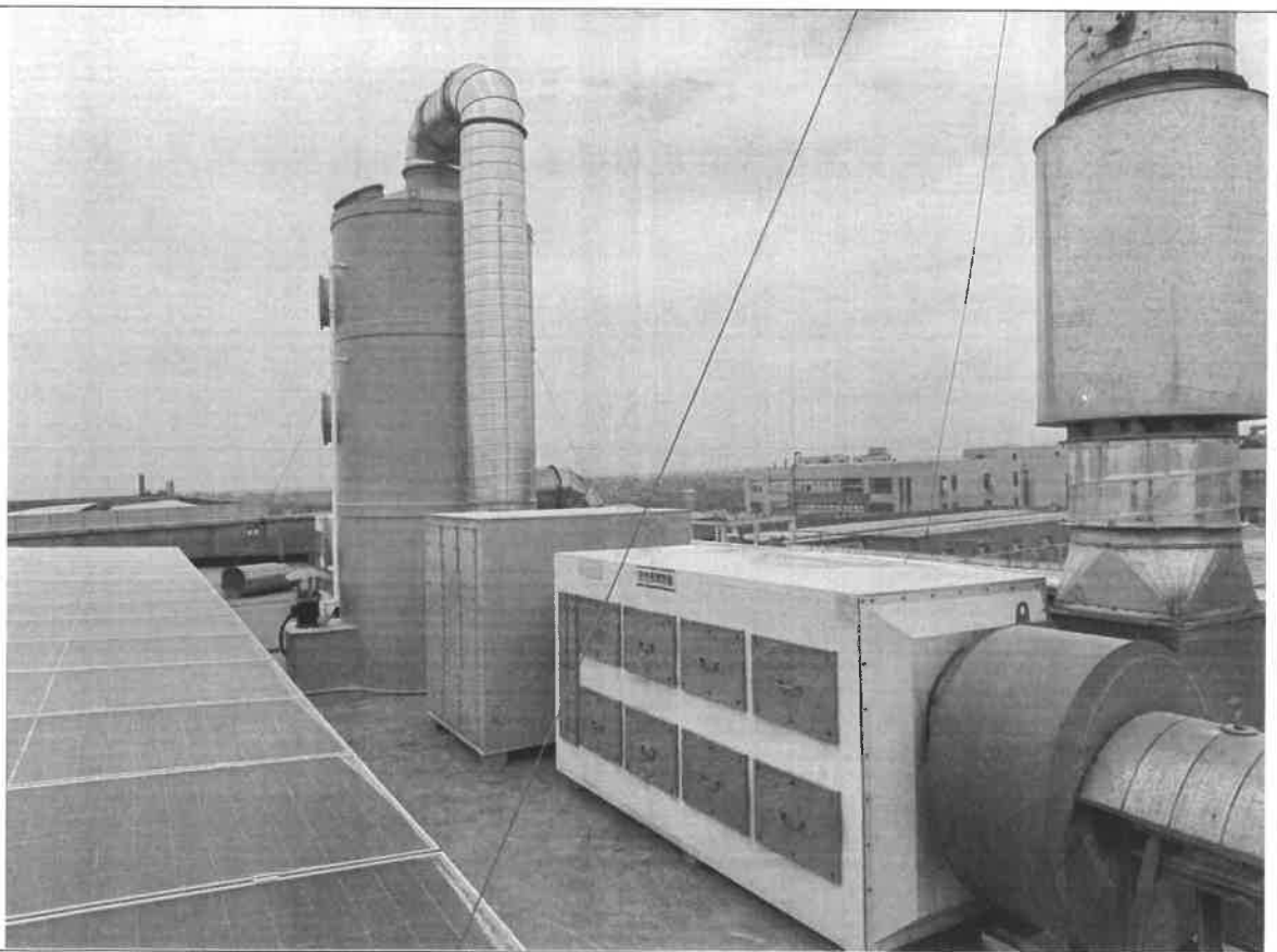
碱喷淋（除雾器）+活性炭吸附（挤出成型废气、复合废气）
