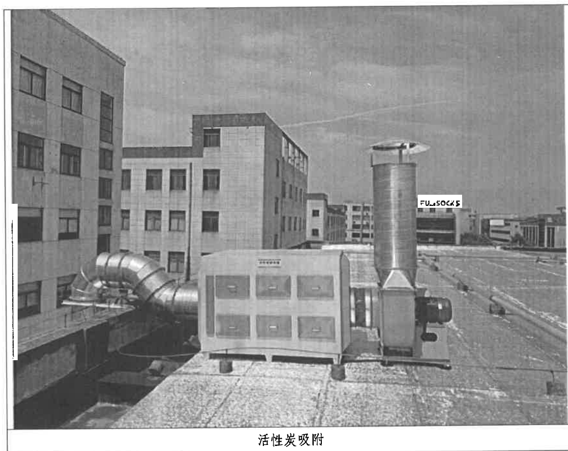
图 4-3 废气治理现场相关照片
