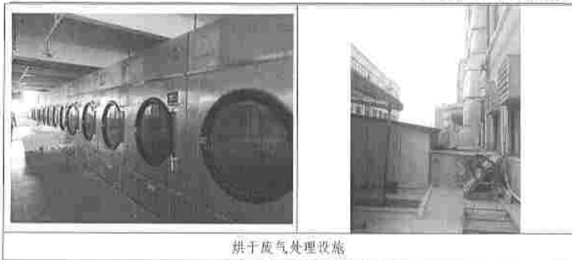
烘干废气处理设施
