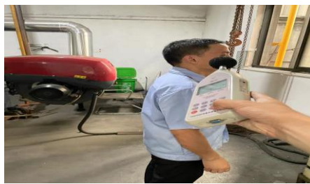
锅炉房巡检岗位
