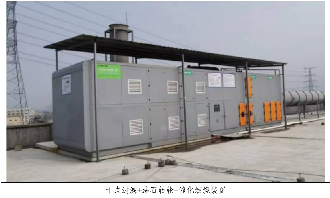
图 4-3 废气处理设施图片
