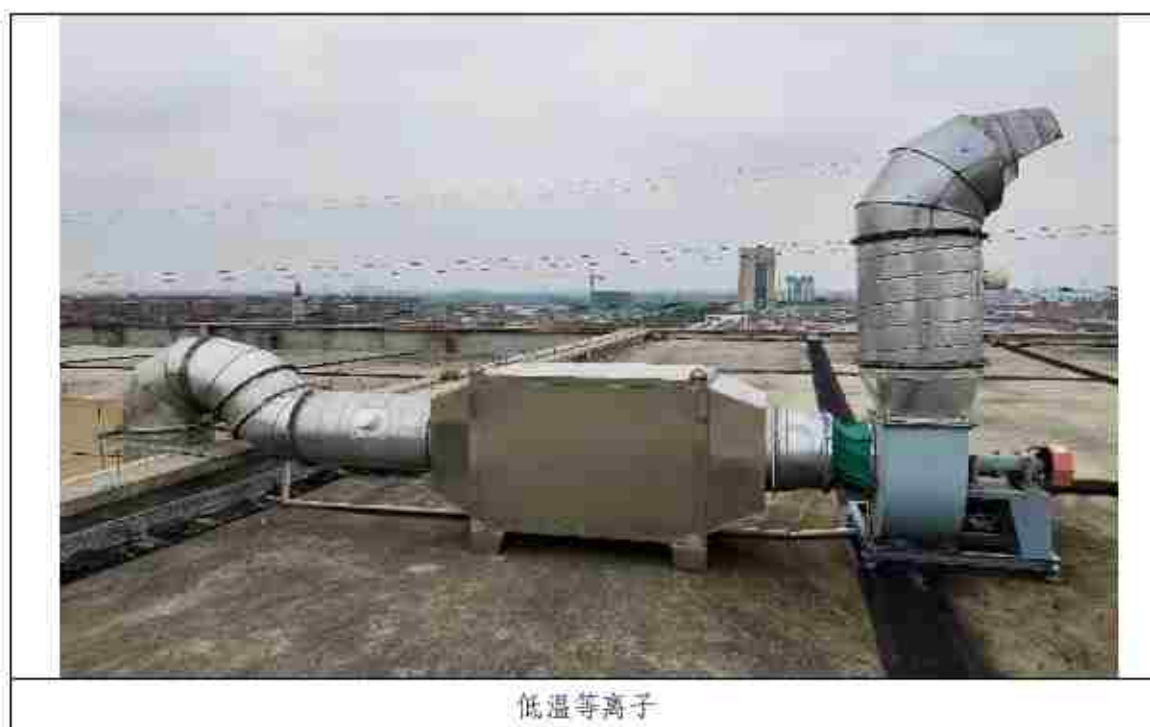
图 4-3 企业废气治理现场相关照片
