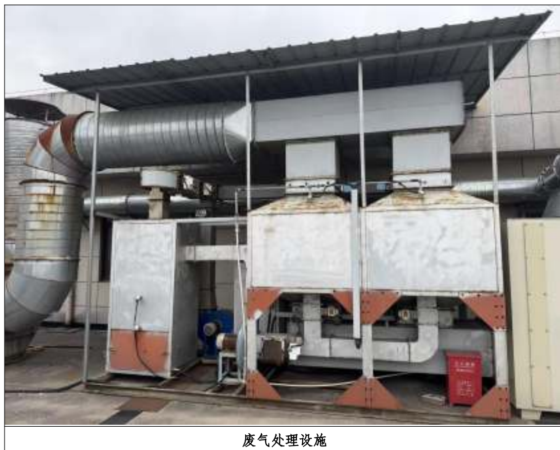
图 4-3 废气处理设施照片
