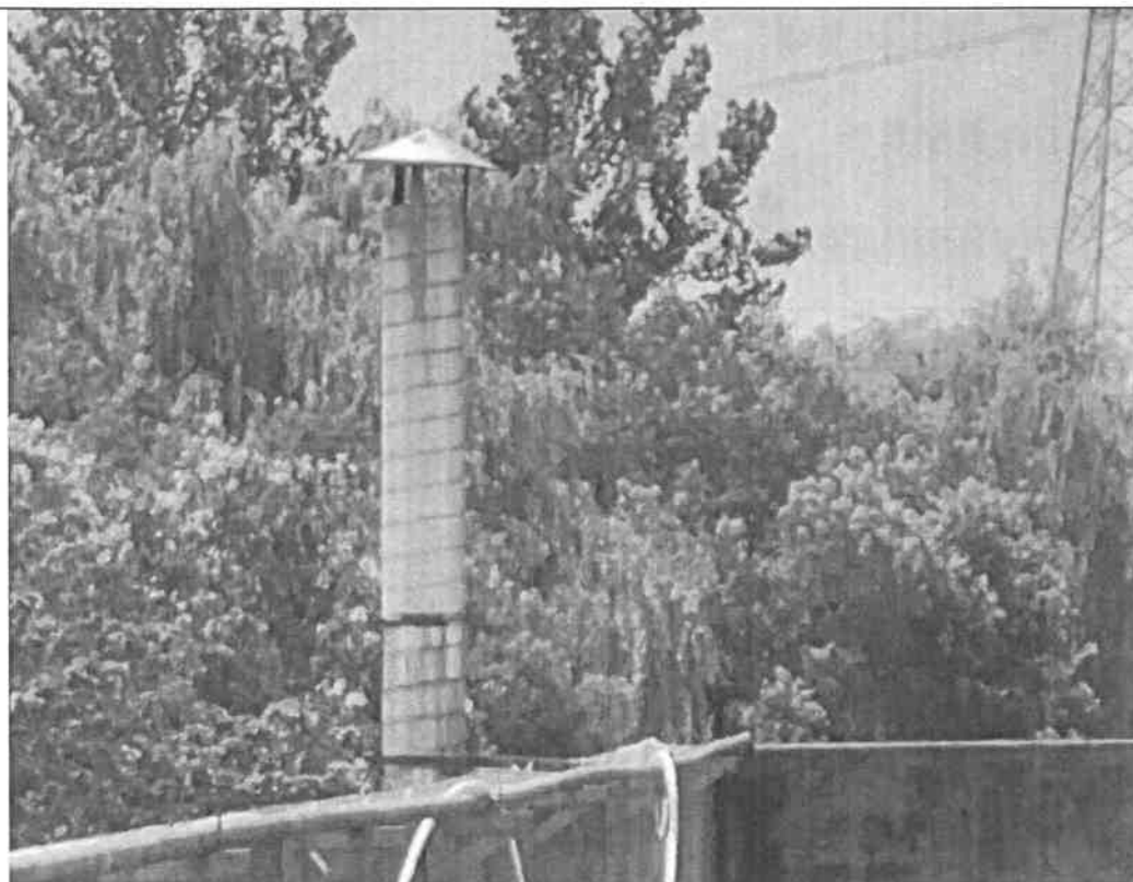
天然气燃烧废气排放口 2#
