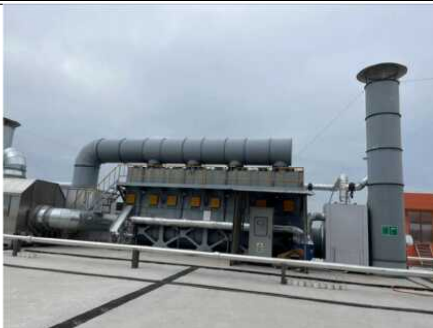
高效干式过滤器-活性炭吸附-脱附再生废气催化燃烧
