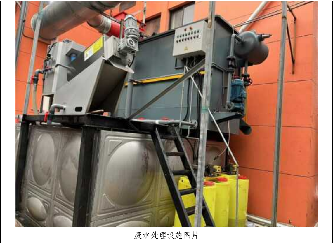
图 4-2 废水处理设施图片
