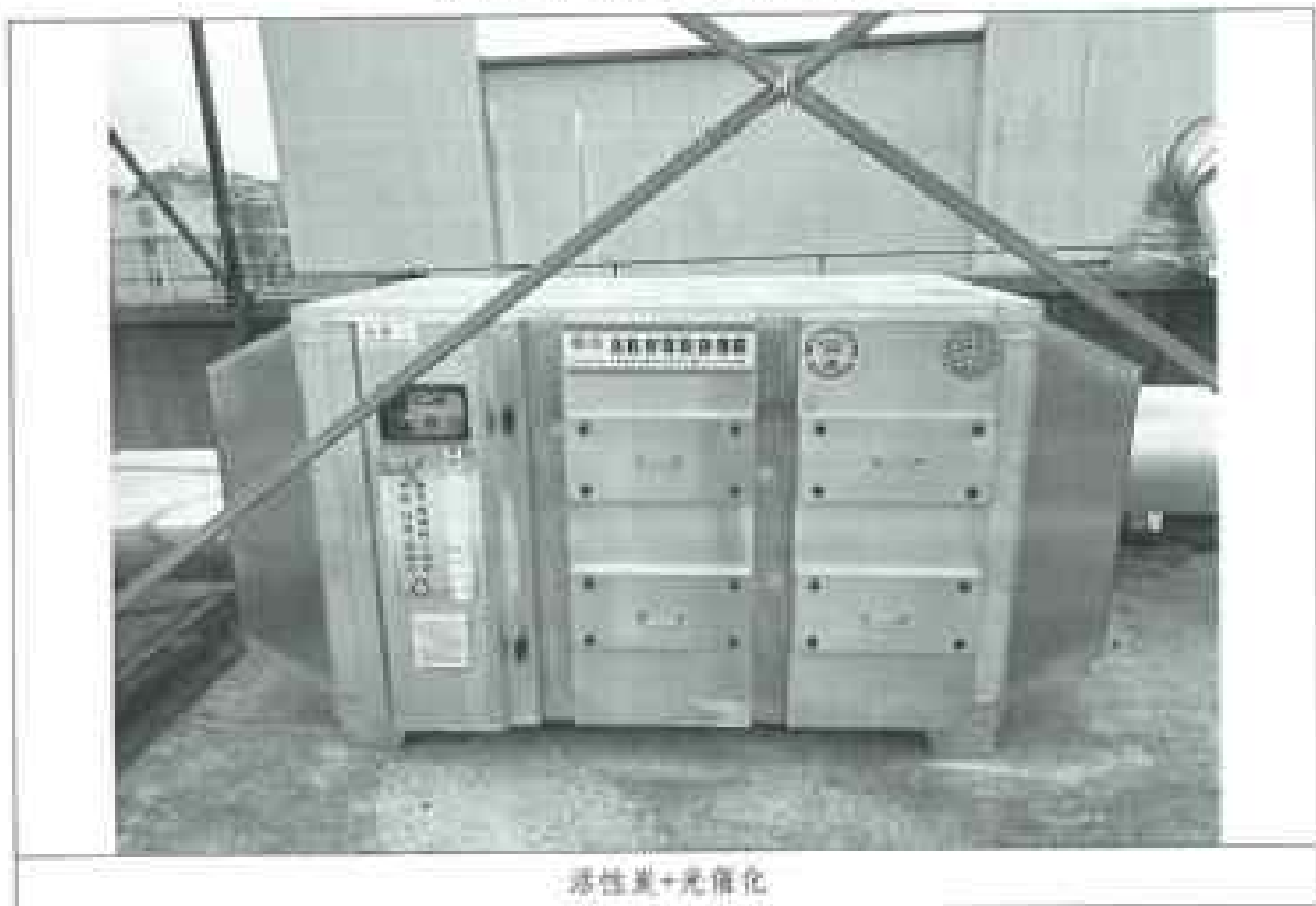
图 4-3 废气治理现场相关照片
