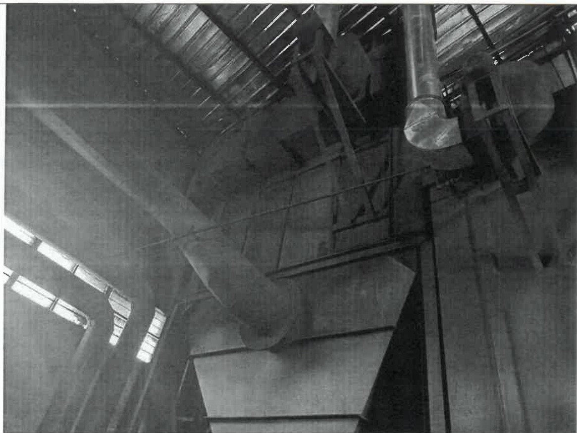
布袋除尘器（1#配料粉尘）
