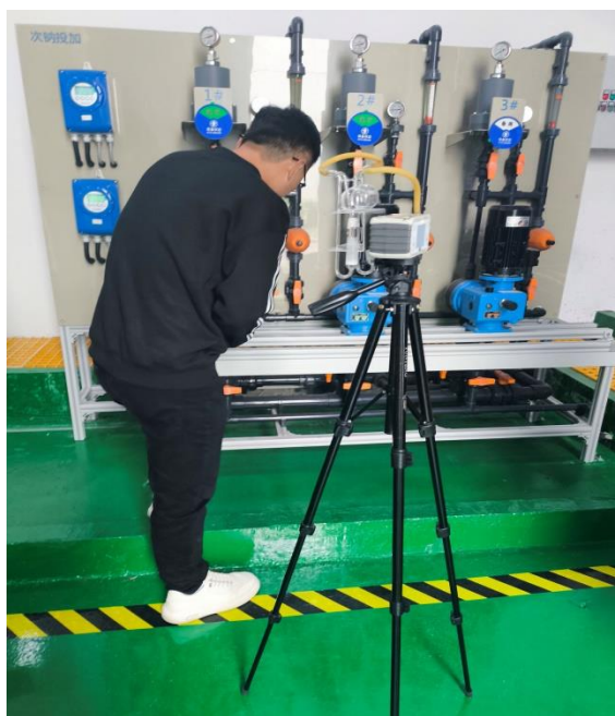
次氯酸钠加药间岗位
