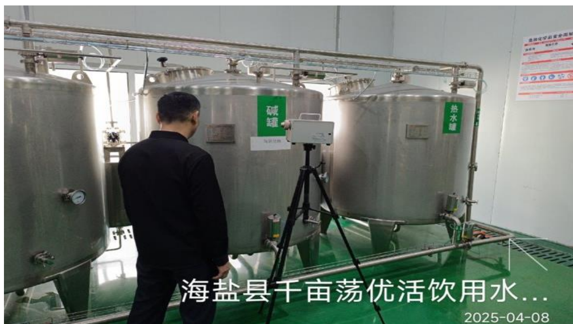
水处理车间净化岗位
