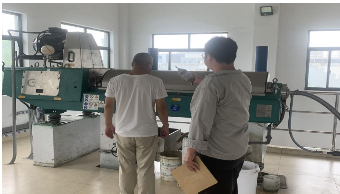
脱水机房巡检岗位
