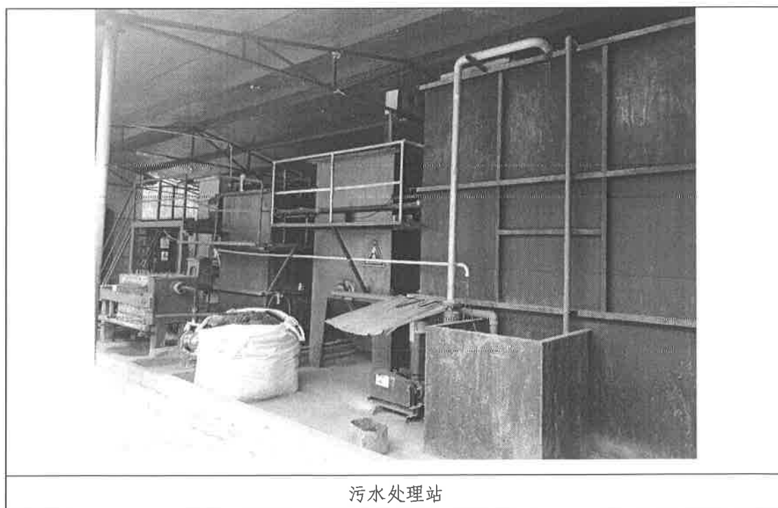
图 4-2 废水处理站图片
