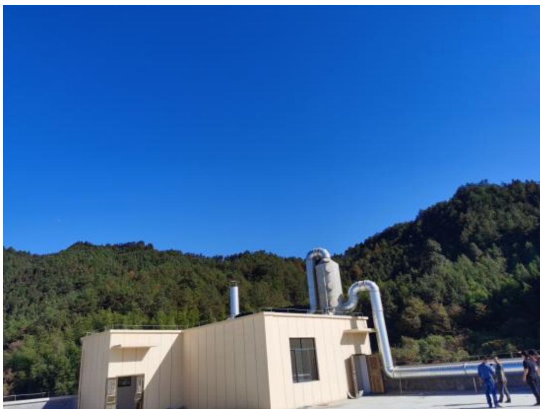
1#喷漆处理设备
