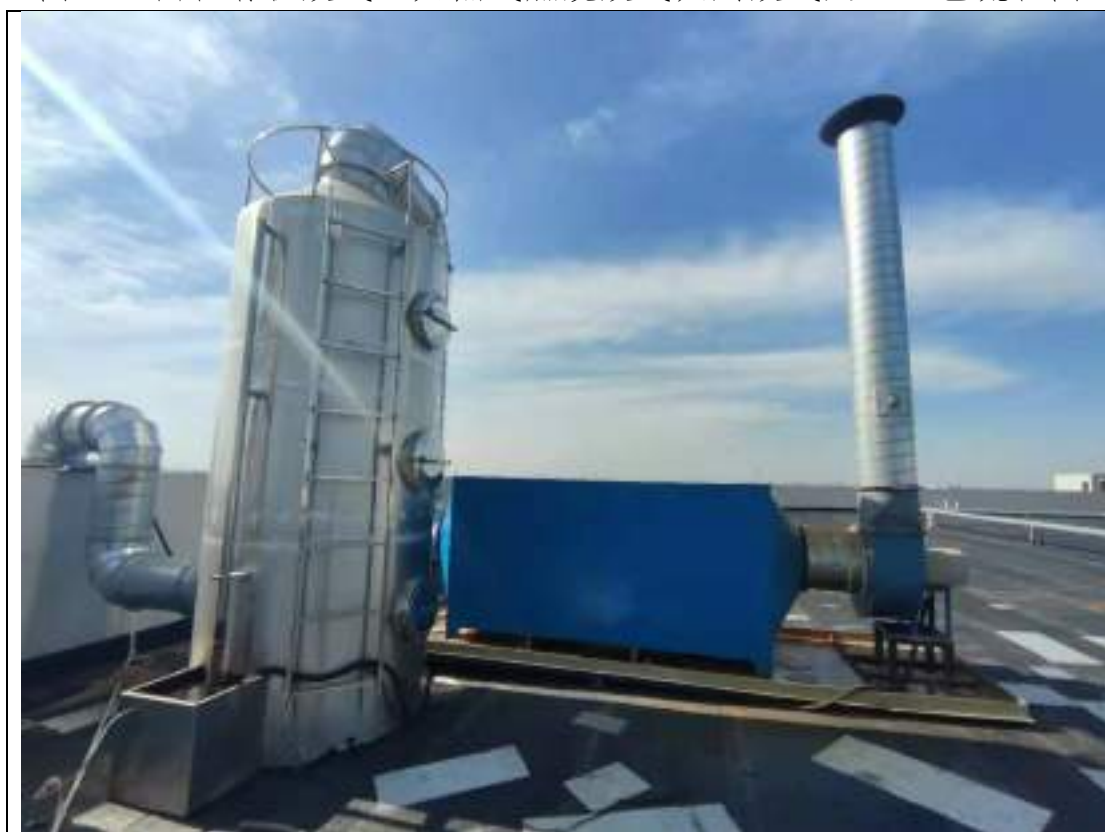
固化有机废气、天然气燃烧废气共用废气处理装置
