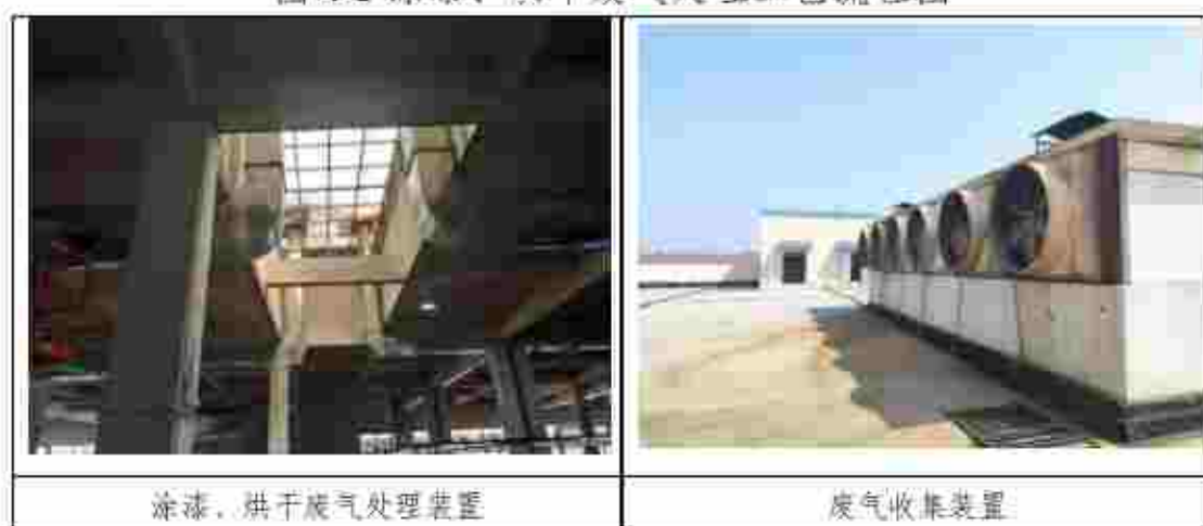
图 4-2 企业废气治理现场相关照片
