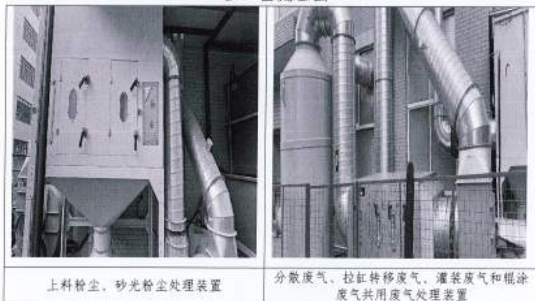
图 4-3 企业废气治理现场相关照片
