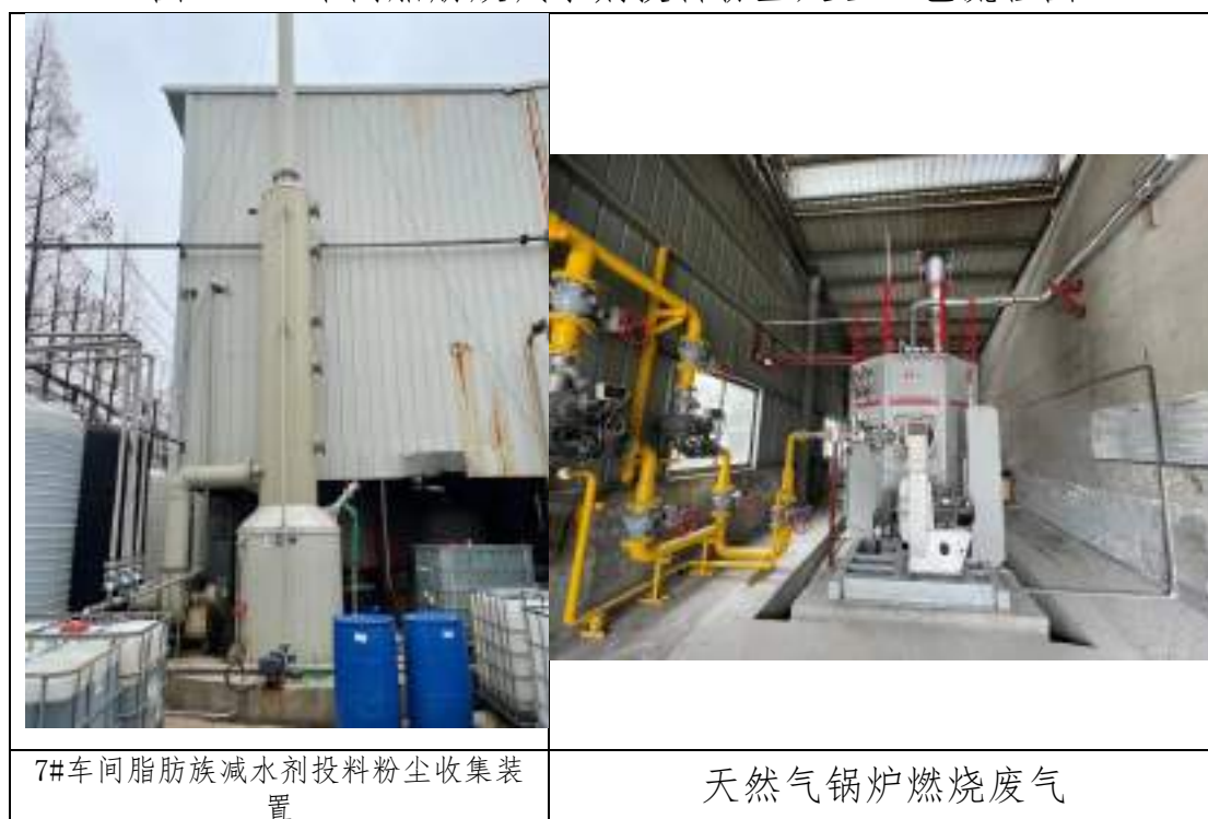
图 4-2 企业废气治理现场相关照片
