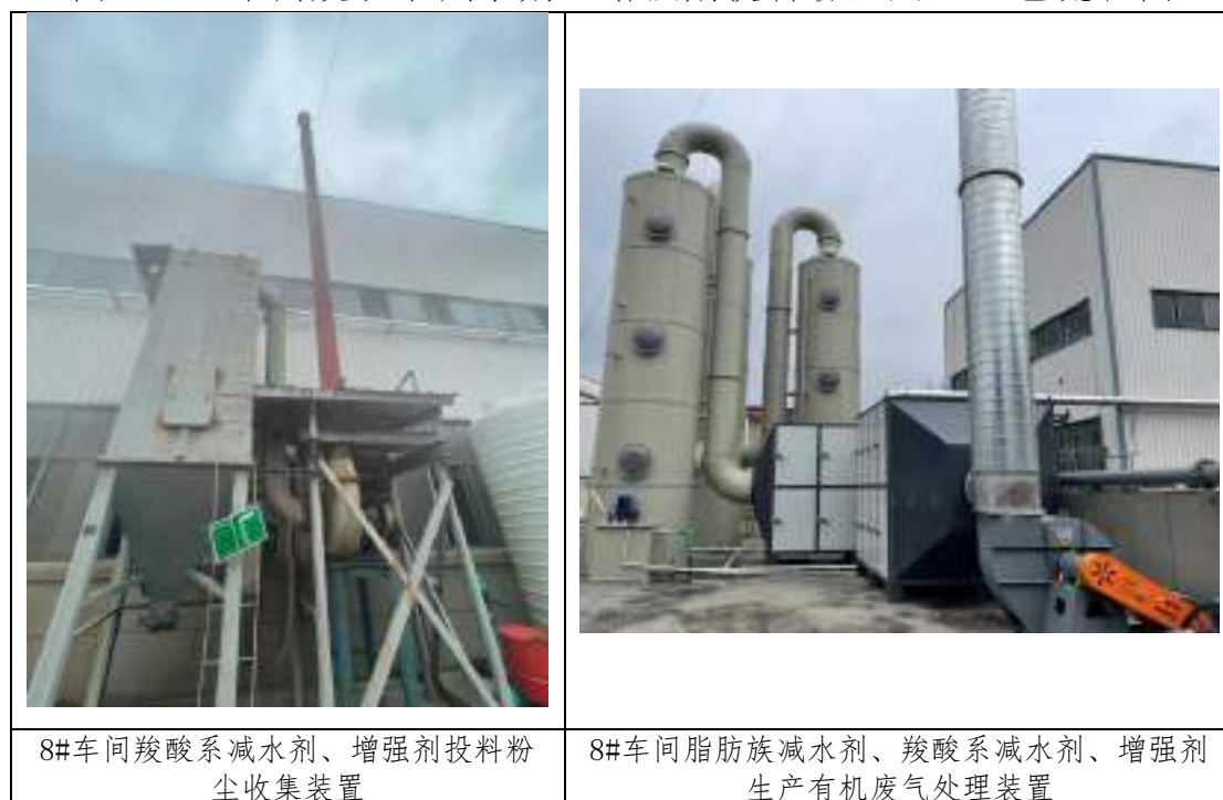
图 4-5 企业废气治理现场相关照片
