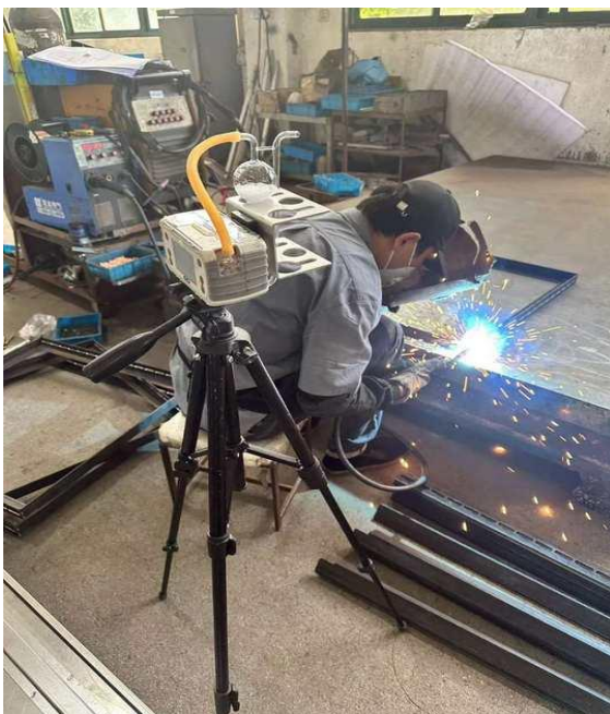
6 号车间气保焊岗位
