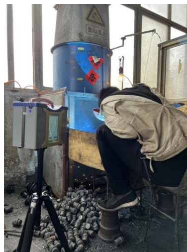
生产车间 3F 电焊
