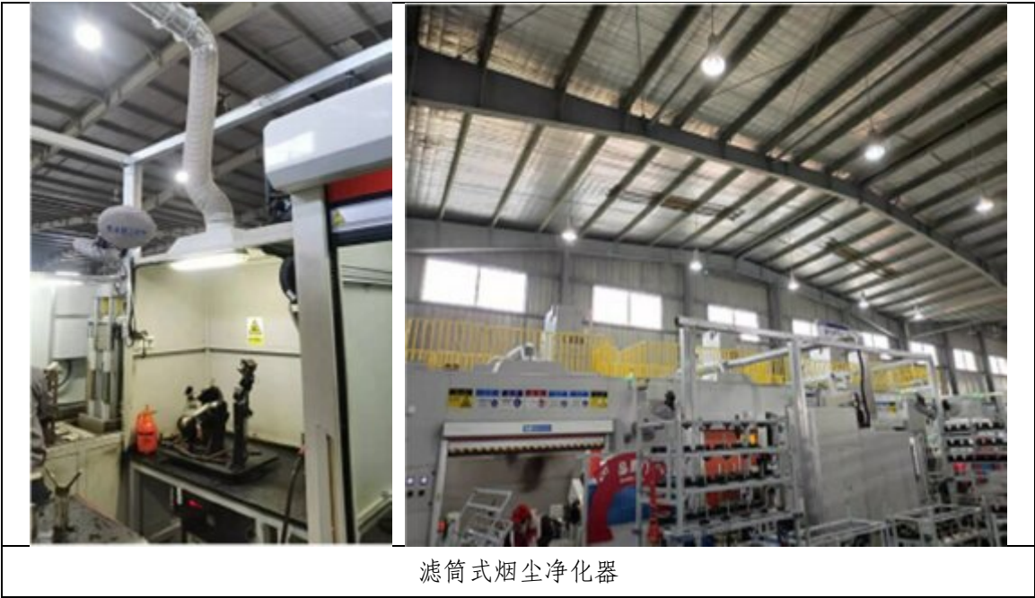
图 4-3 企业废气治理现场相关照片
