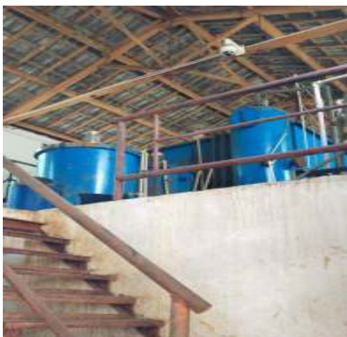
图 4-2 生产废水处理站
