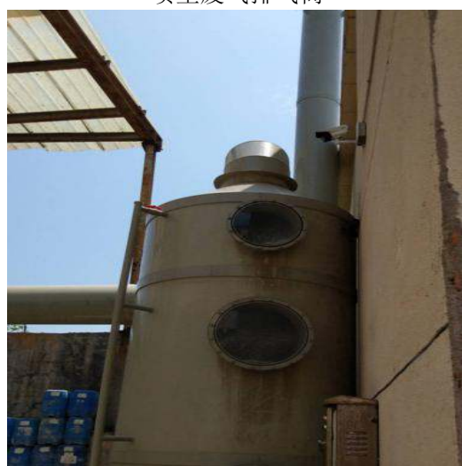
酸雾废气排气筒
