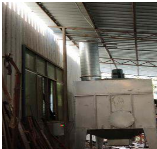
焊接废气排气筒
