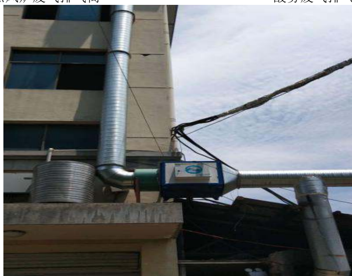
食堂油烟排气筒
