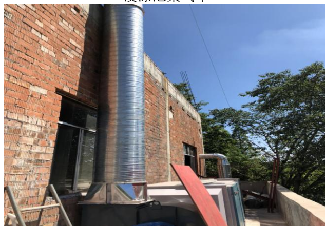
废气处理设备
