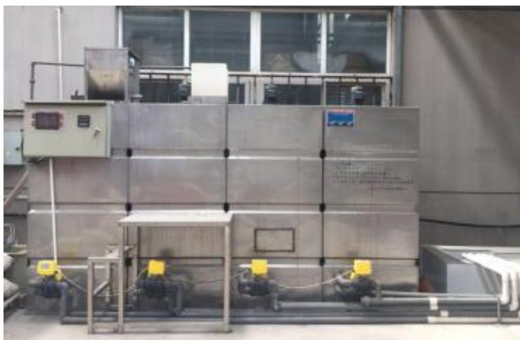
生产废水处理站
