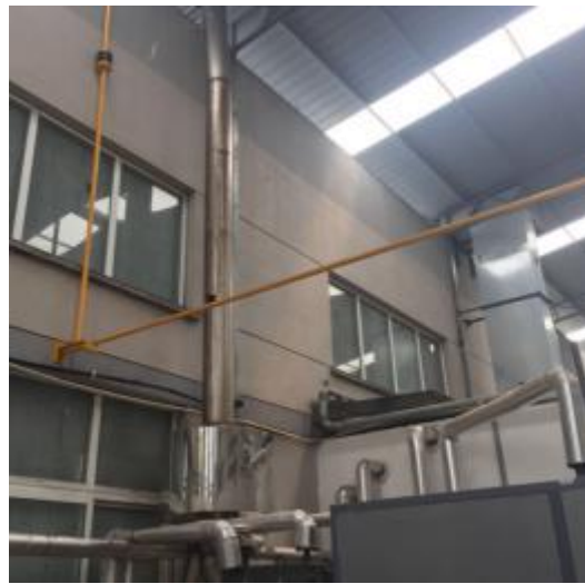
天然气废气排气筒
