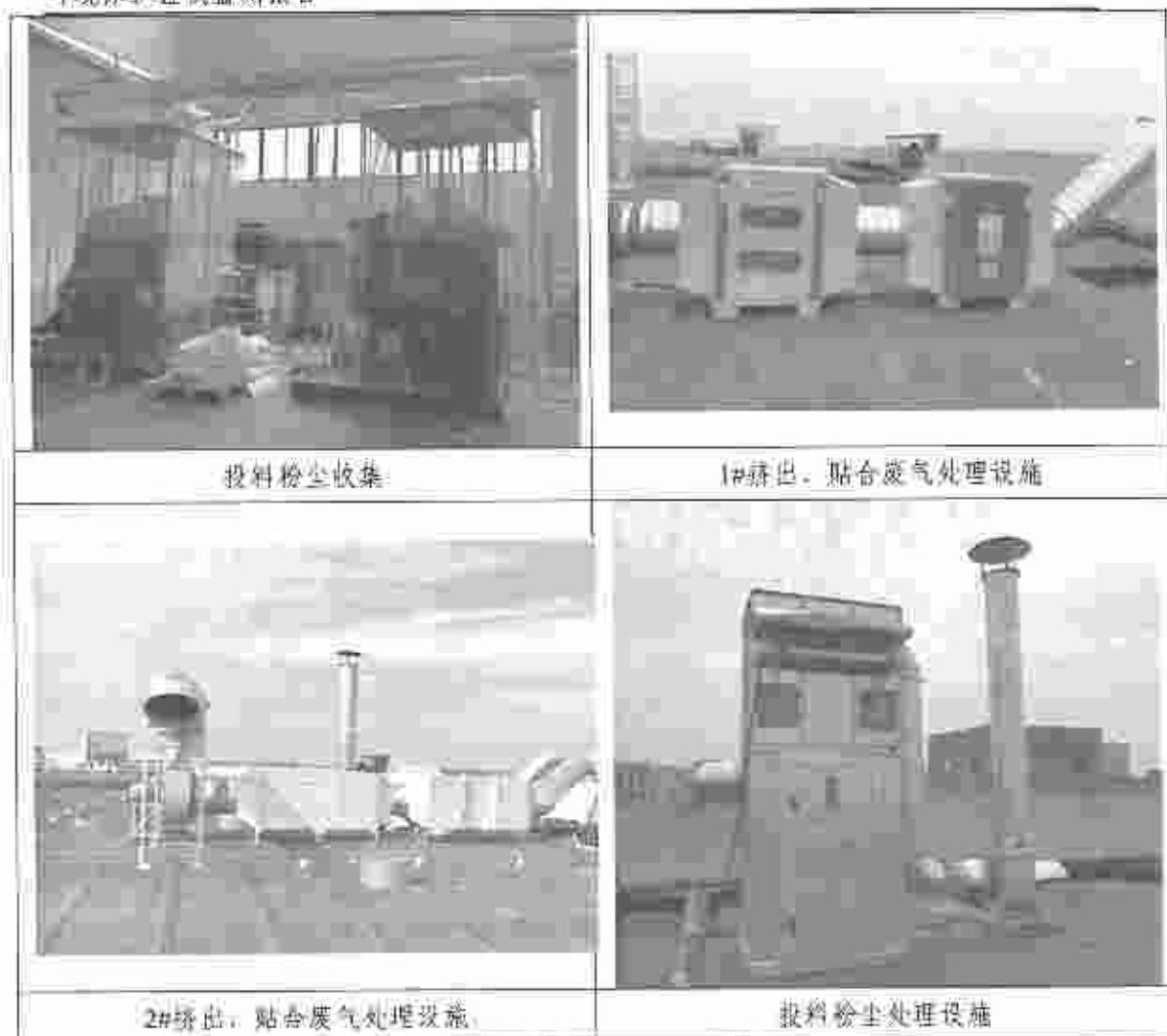
图 4-3 废气治理现场相关照片
