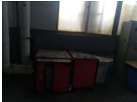
废气处理设备
