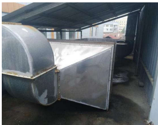
用漆废气处理设备
