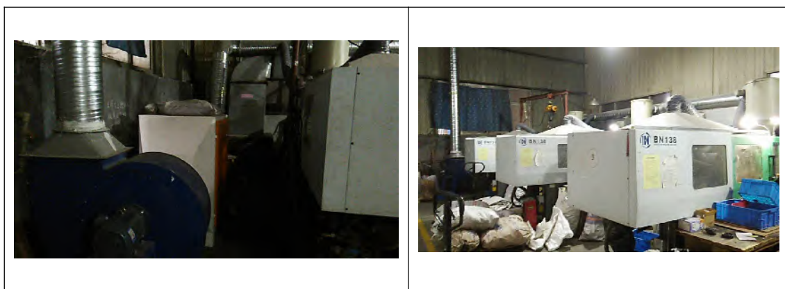
图 4-4 企业废气治理现场相关照片
