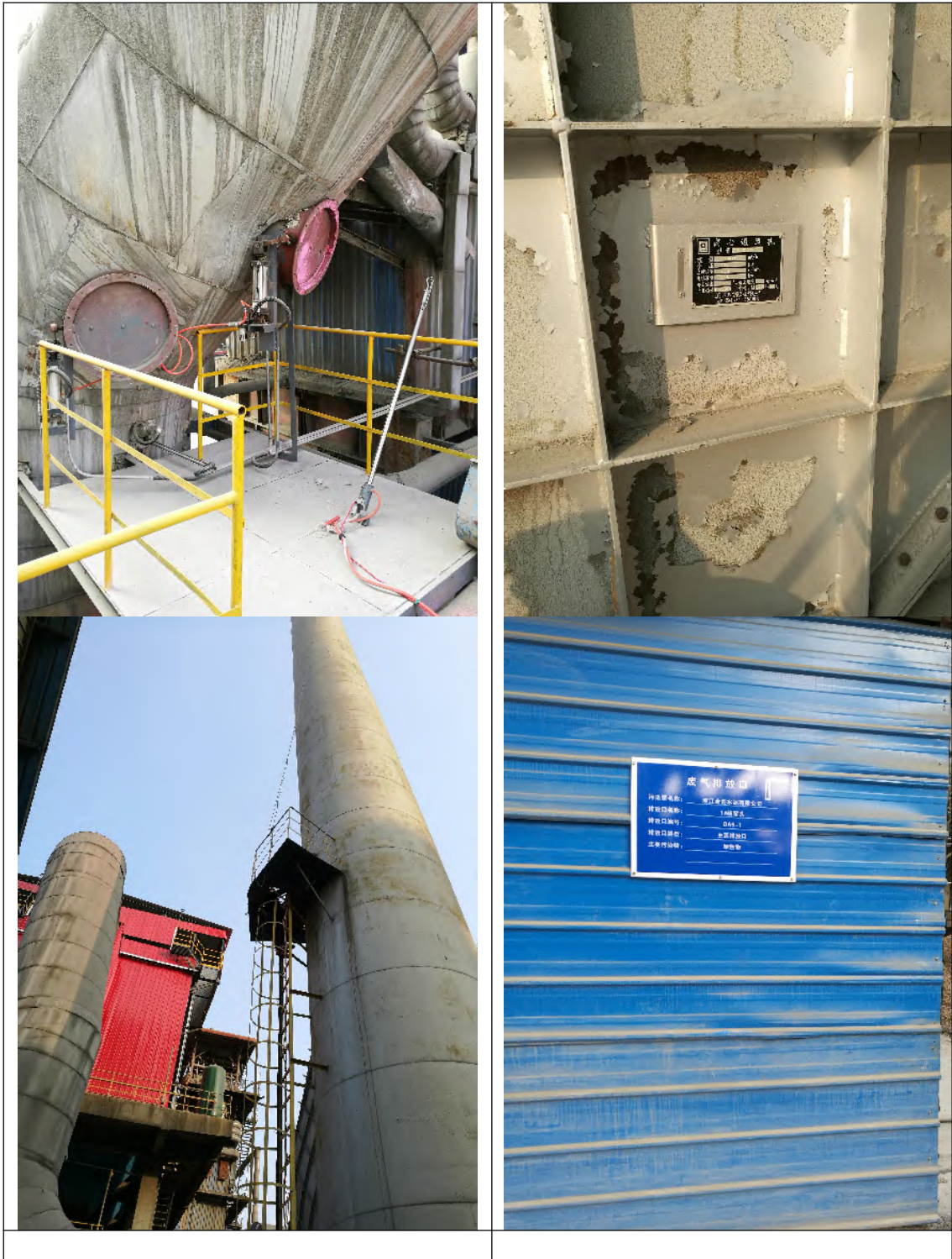
废气处理设施相关照片
