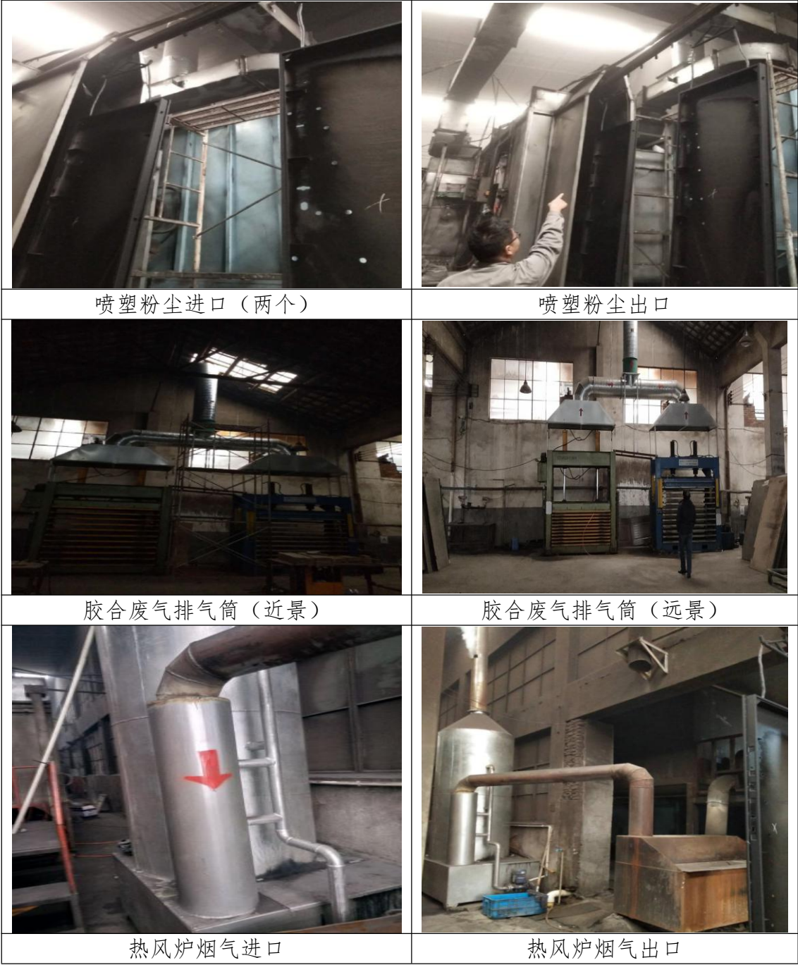
图 4-3 企业废气治理现场相关照片
