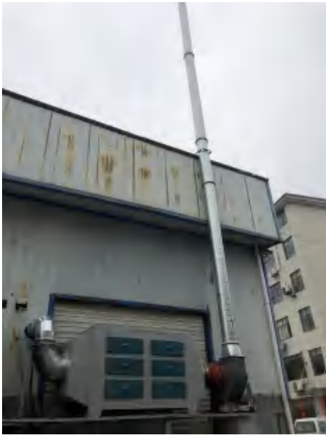
印刷废气处理设备
