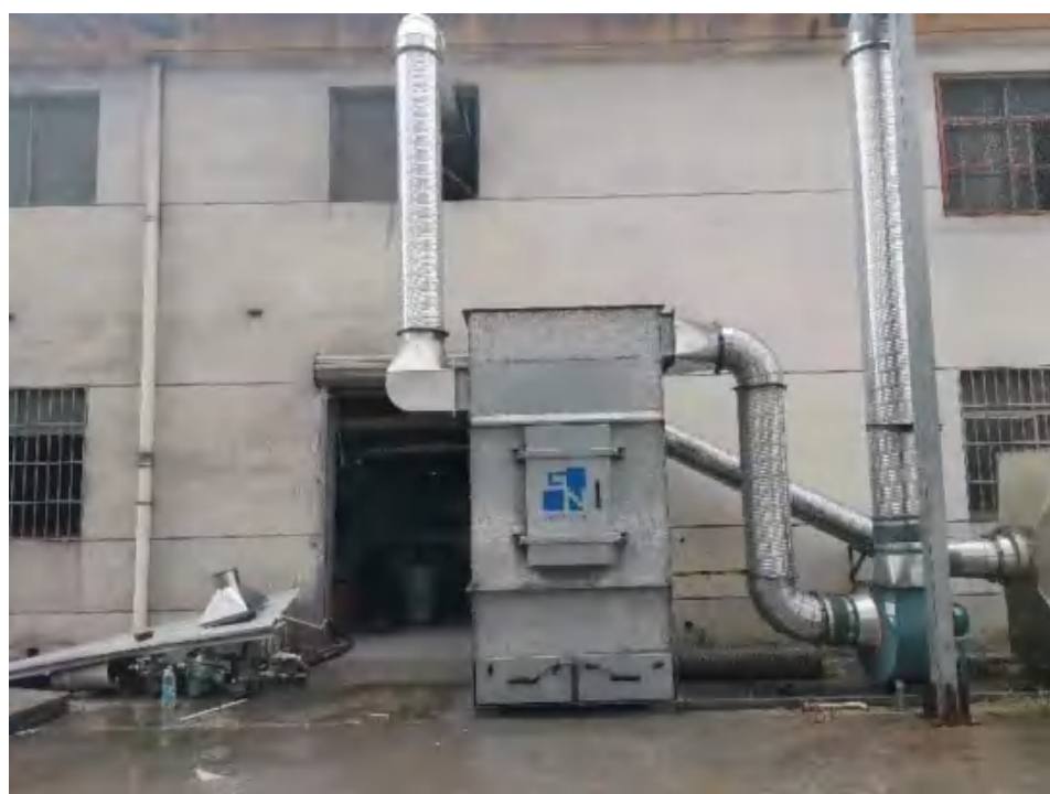
废气处理设施照片
