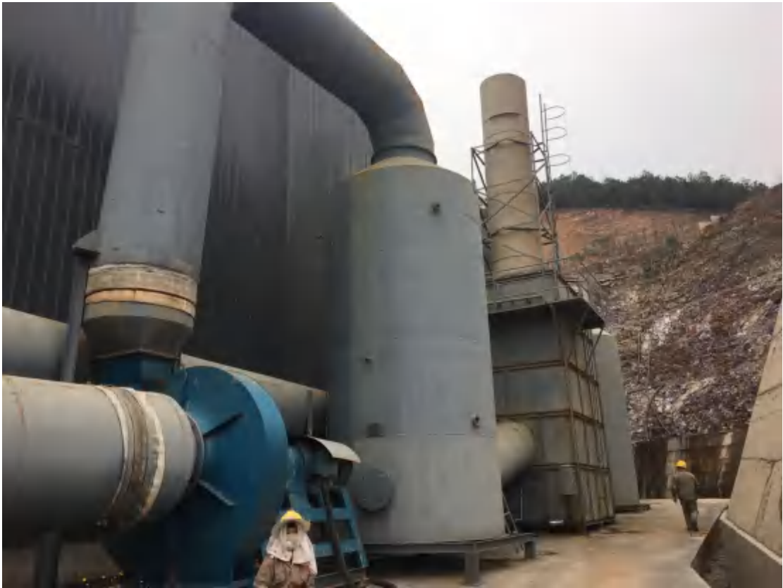
废气治理工程
