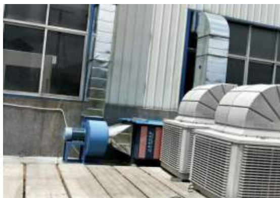
废气处理设备
