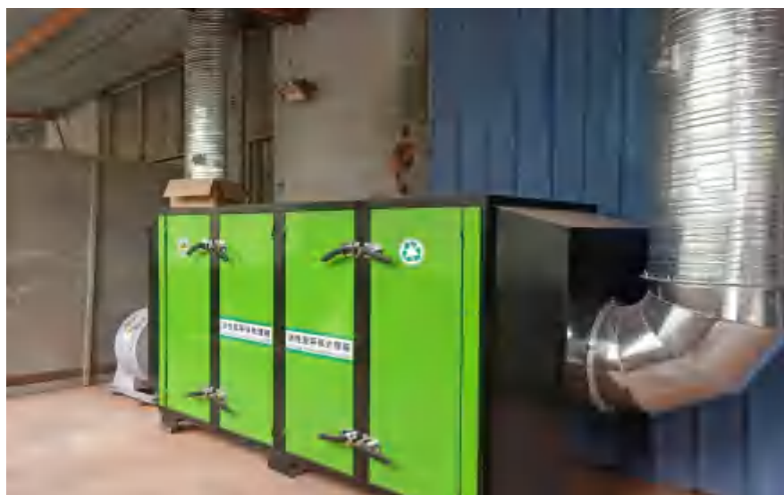
固化废气处理设备
