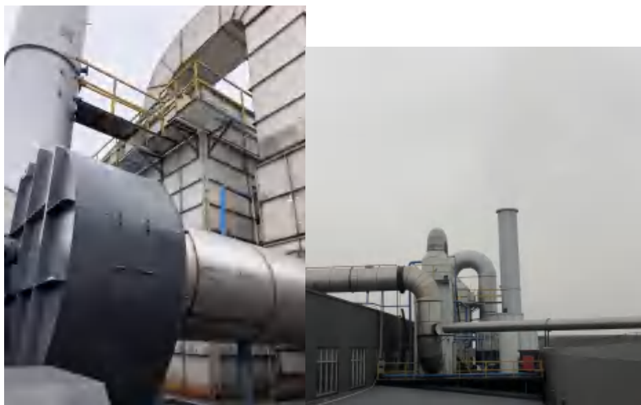
定型废气处理设备
