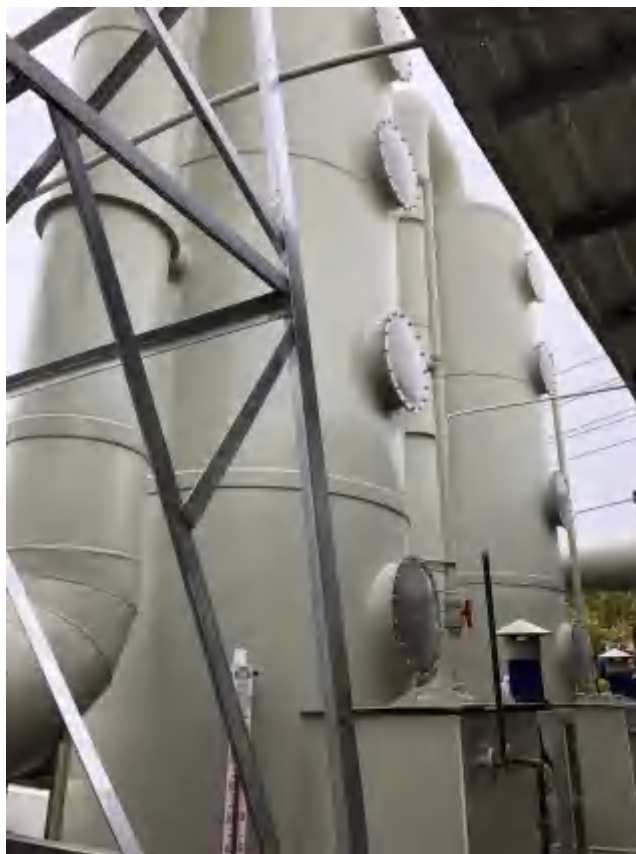
恶臭废气处理设备
