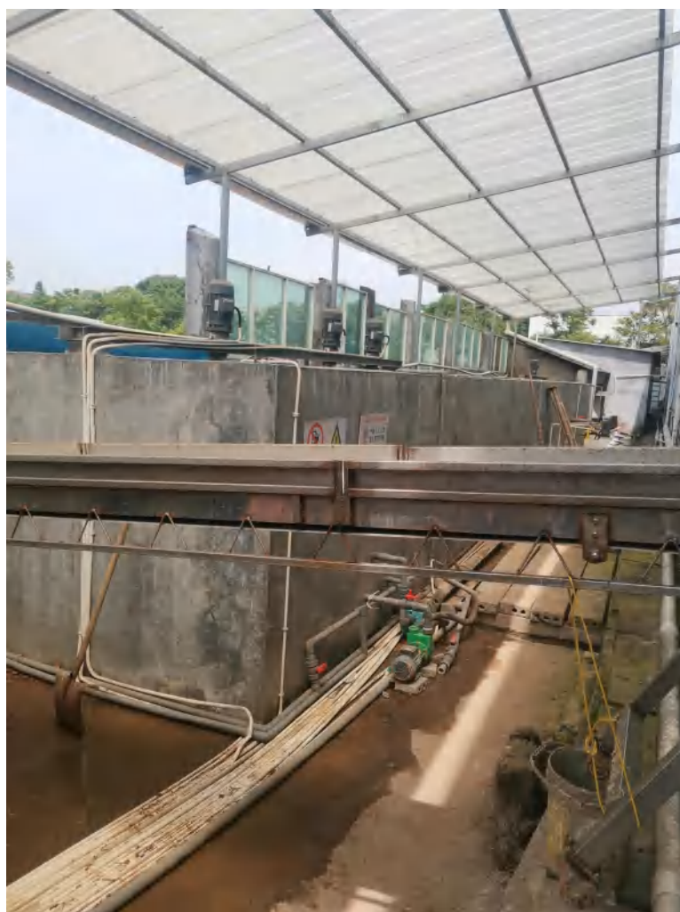
废水处理设施照片
