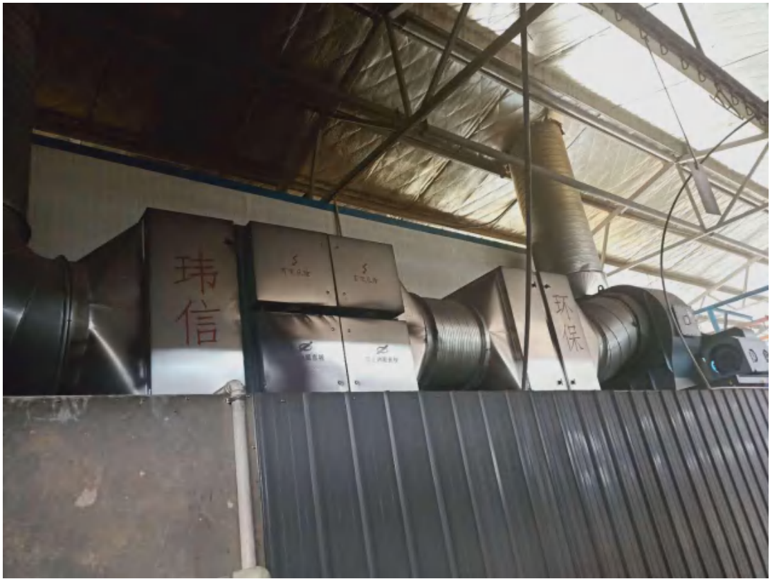
喷漆废气处理设备
