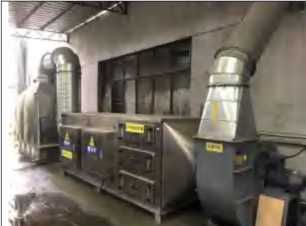
烘干、固化废气处理设备
