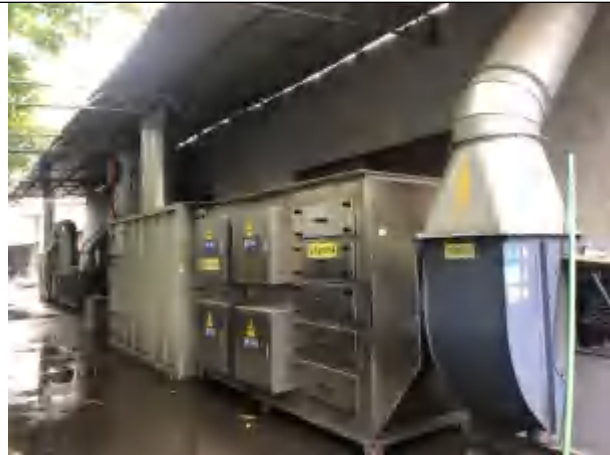
喷漆废气处理设备
