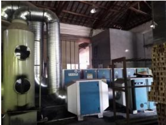
废气处理设备
