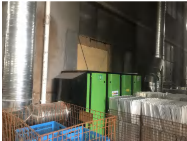
固化废气处理设备
