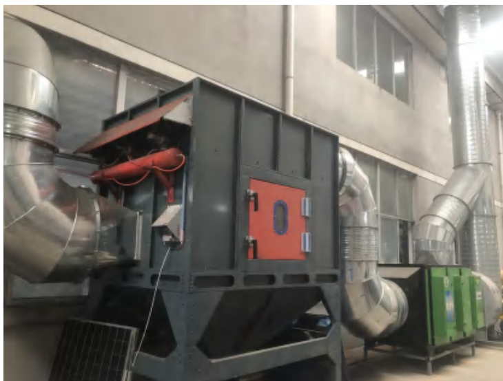
焊接废气处理设备
