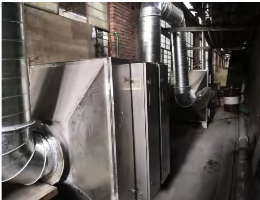
废气处理设施照片
