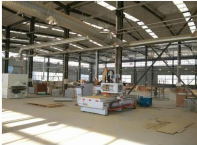
吸尘风管安装实例(公司产品)
