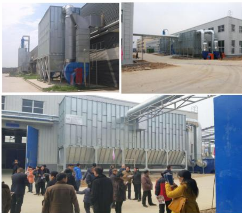
图片为我司为博洛尼家居用品(北京)有限公司安装的中央除尘系统
