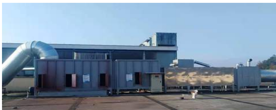
喷漆废气处理设备
